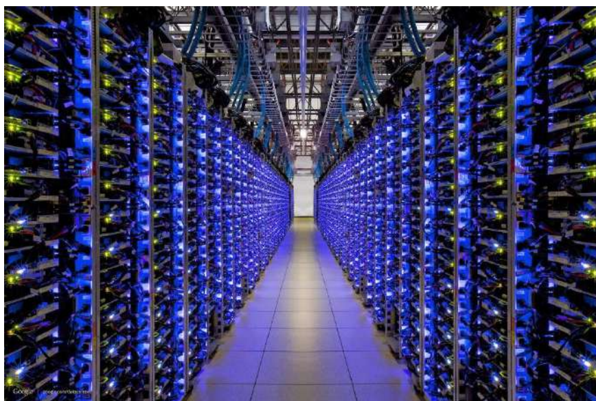
Data center (centre de données).
